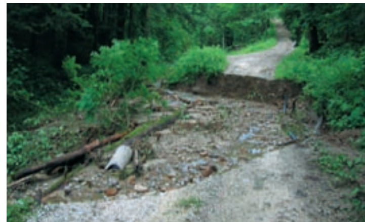
Rutsch einer Waldstrasse entlang Bach nach Gewitter
